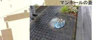
マンホールの蓋
